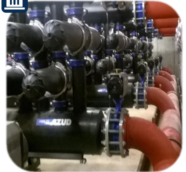
7 x AZUD HELIX AUTOMATIC FT4DC12 2.180 m 3 /h | 100 µm | Italia Pabellones Milán EXPO 2015
