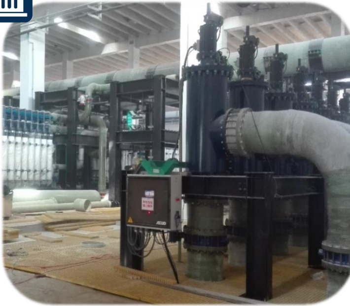
7 x AZUD LUXON LDB 20100/20 SW 5.250 m 3 /h | 100 μm | China Qingdao Planta desalinizadora
