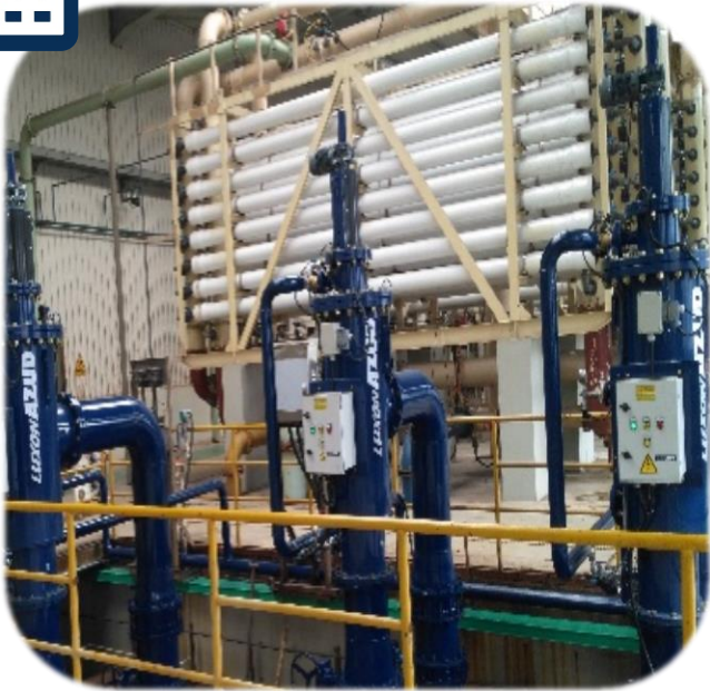
3 x AZUD LUXON LDB 13200 S/14 500 m 3 /h | 100 μm | China Shandong reúso de agua
