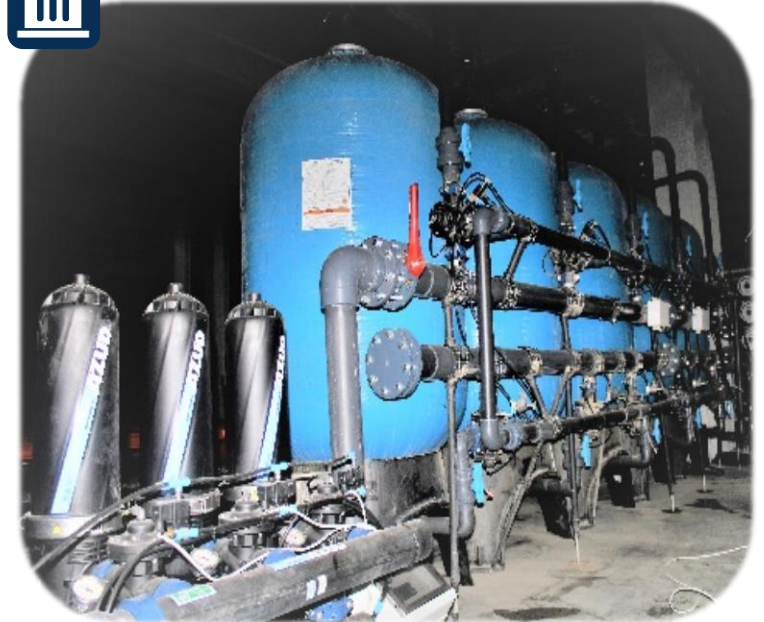
1 x AZUD HELIX AUTOMATIC 203 45 m 3 /h | 200 μm | Rusia Línea de tratamiento de agua de servicio
