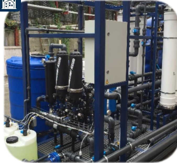
1 x AZUD HELIX AUTOMATIC 202 AA 20 m 3 /h | 100 μm | Francia Lavandería Guadalupe Island hotel
