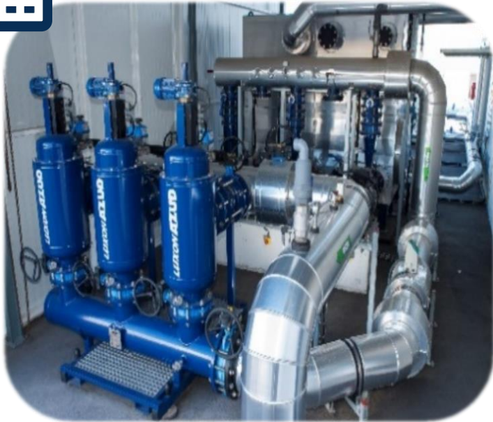
3 x AZUD LUXON LDB 5400 S/8 300 m 3 /h | 125 µm | España Circuito de refrigeración moldes de inyección
