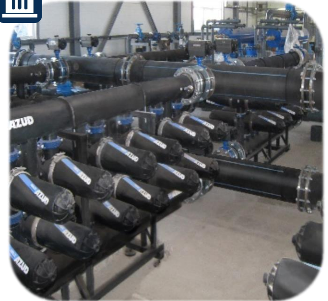
6 x AZUD HELIX AUTOMATIC 4DC12 1.000 m 3 /h | 20 μm | Rusia Shemursha City planta de tratamiento
